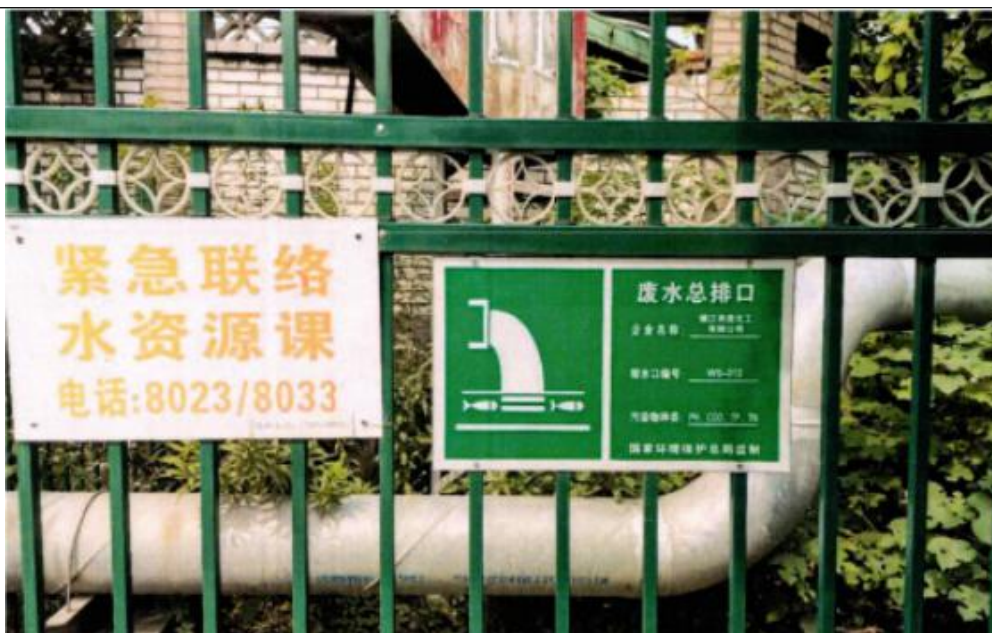
图 3-6 废水总排放口
